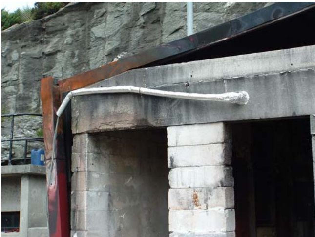
Figur 4.20 Isolering av strålefluksmeter og føring av kabler
