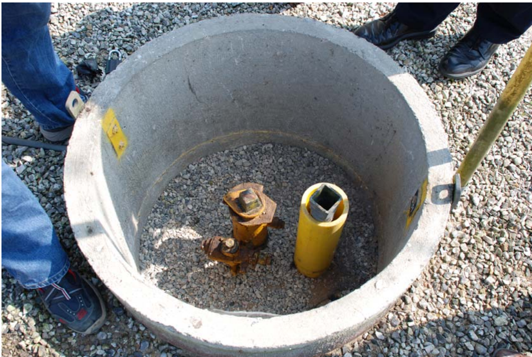
Bilde 8: Stengeventil fra MR-stasjon [27]
