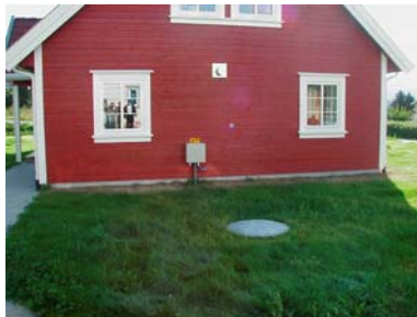
Bilde 2: Nedgravd propantank med tilhørende abonnentsentral [17]
