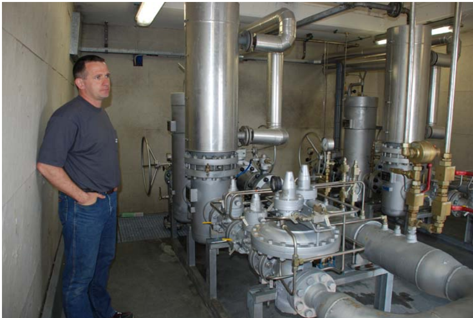
Bilde 17: En MR-stasjon innvendig [27]
