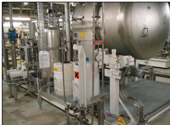
Figur 5 Drikkevannsanlegg offshore med evaporator, avleiringshemmer, klortank, alkaliseringsfilter og UV-anlegg. Foto E. Andersen. (Evaporasjon)
