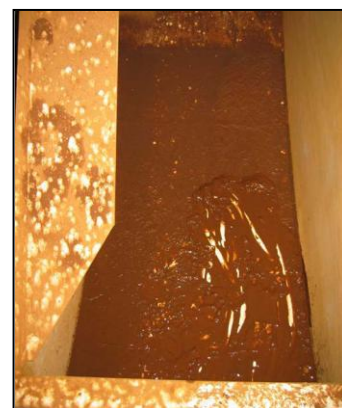
Figur 7 Bunnslam i en drikkevannstank offshore. Foto Bjørn Løfsgaard. (Tank)
